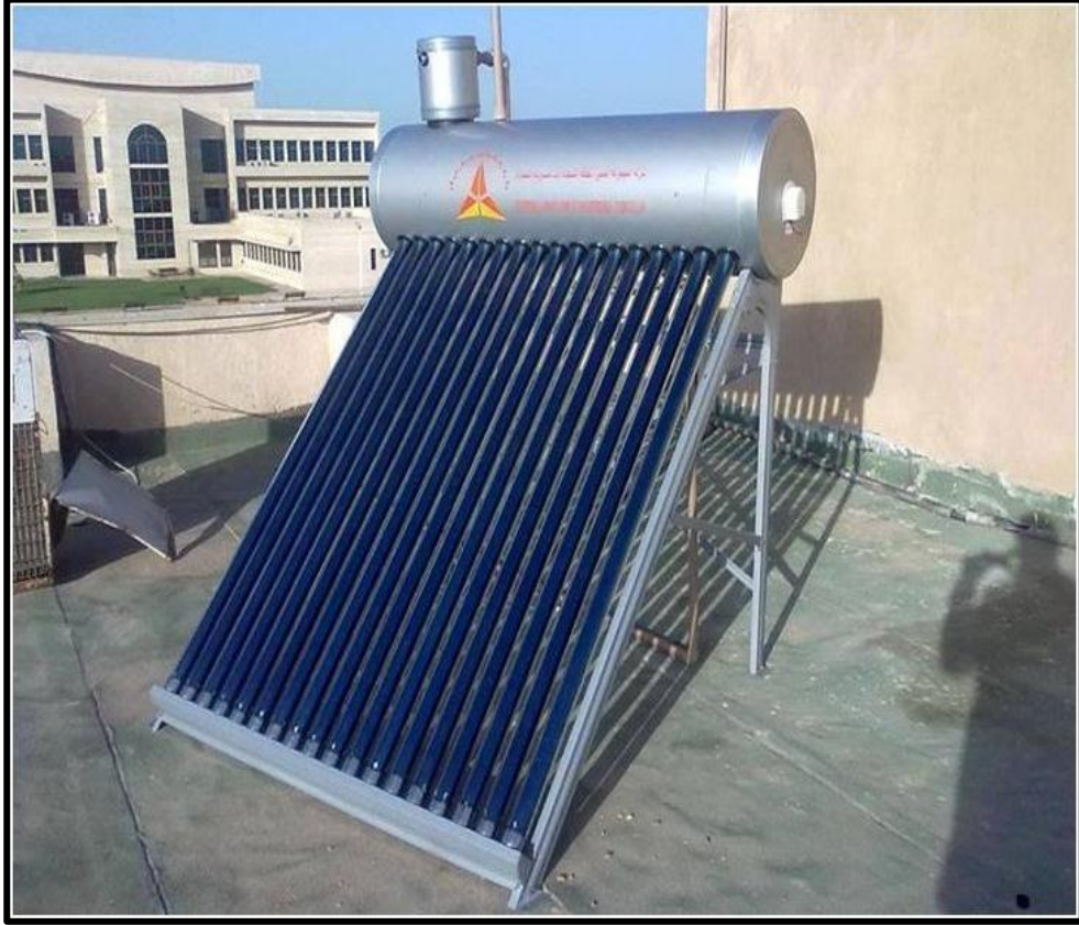
شكل (٥) منظومة تسخين المياه في ميناء طرابلس البحري عام ٢٠١٣ م
