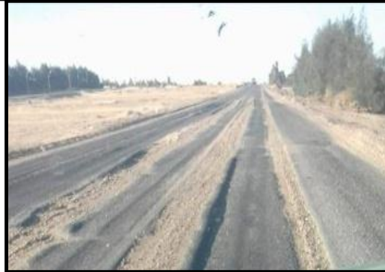
صورة (٥) تموجات في قطاع بطريق أسيوط الغربي صورة (٦) تموجات في قطاع بطريق الإسماعيلية / بورسعيد
