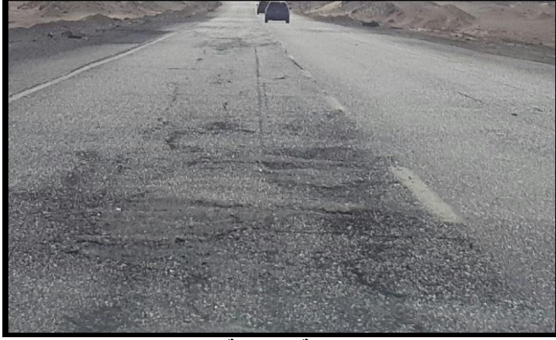
الصورة (٤) توضح تشققات الطبقة السطحية بطريق بطريق القاهرة / الفيوم
